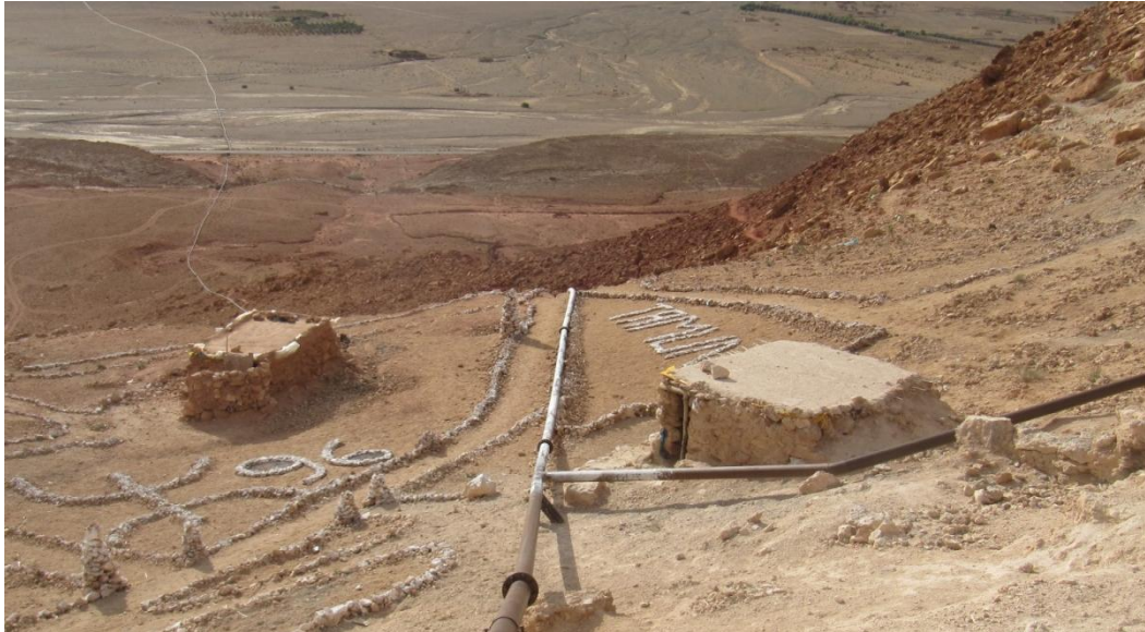
Canalisations acheminant l'eau vers la mine
