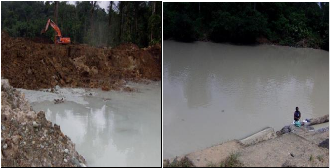
Fotografía 4 y 5. Piscina de recirculación minera, que rompe su muro de contención y contamina el río Cachavi con afectaciones más allá de 20 km aguas abajo donde mujer lava ropa en localidad de Urbina
